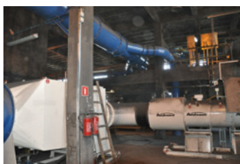
Rys. 7. Miejsce zabudowy szeregowo połączonych wentylatorów Korfmann typoszeregu ESN-9/550 [7]
