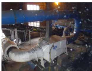
Rys. 8. Miejsce zabudowy odpylacza mokrego HCN1100/1 w układzie centralnym odpylania [7] Fig. 8. Installation location of the HCN1100/1 wet dust collector in the central dust removal system [7]
