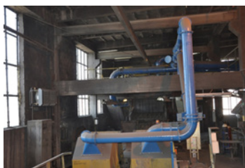
Rys. 6. Zabudowany punkt odbioru zapylnego powietrza na obiekcie kruszarni [7]
