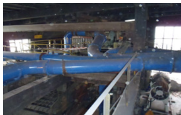
Rys. 9. Przewody wentylacyjne – kształtki i sposób ich łączenia [7] Fig. 9. Ventilation ducts – fittings and their connection method [7]
