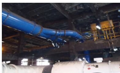
Rys. 10. Przewód zbiorczy doprowadzający zabrudzone powietrze do odpylacza HCN [7] Fig. 10. Collecting pipe supplying contaminated air to the HCN dust collector [7]
