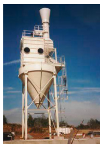
Rys. 13. Instalacja odpylająca kruszarkę w kopalniach wapienia (CFT Polska, 2024) Fig. 13. Crusher dust removal installation in limestone mines (CFT Polska, 2024)
