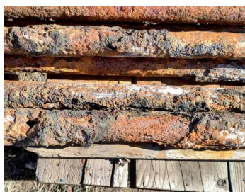
Rys. 1. Skorodowane rury wykorzystywane do eksploatacji wód mineralnych
